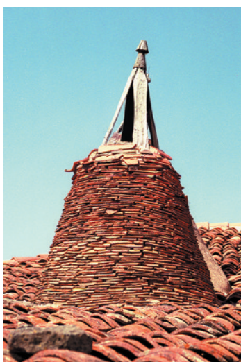
La clásica chimenea encestada serrana, hecha en teja y rematada por su 'chipitel', ha llamado siempre la atención a los visitantes de esta comarca, y escritores de la talla de Baroja y Unamuno dejaron constancia de ello en sus novelas.
